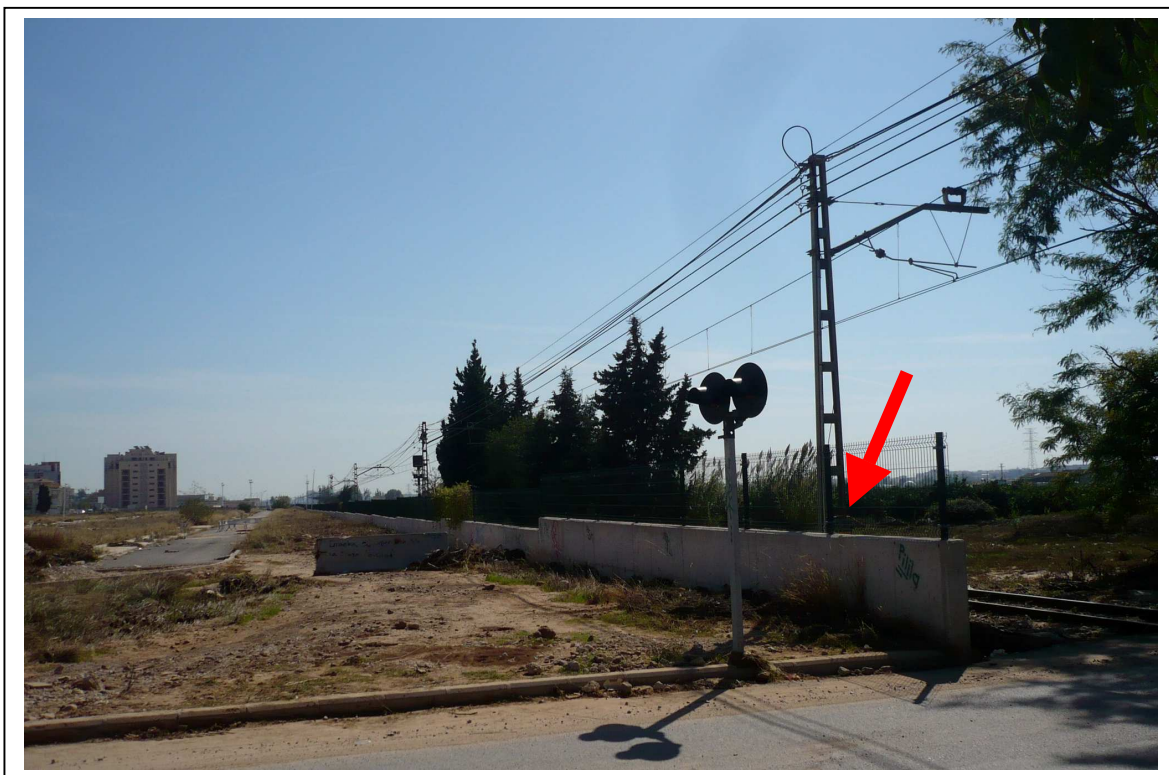
Mur de les vies de FGV
