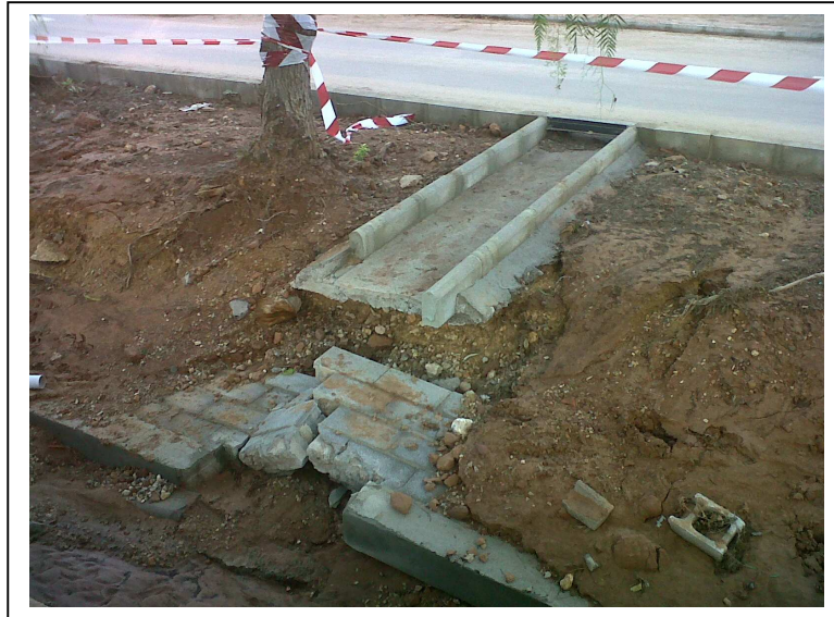
Murs destrossats per la pluja
